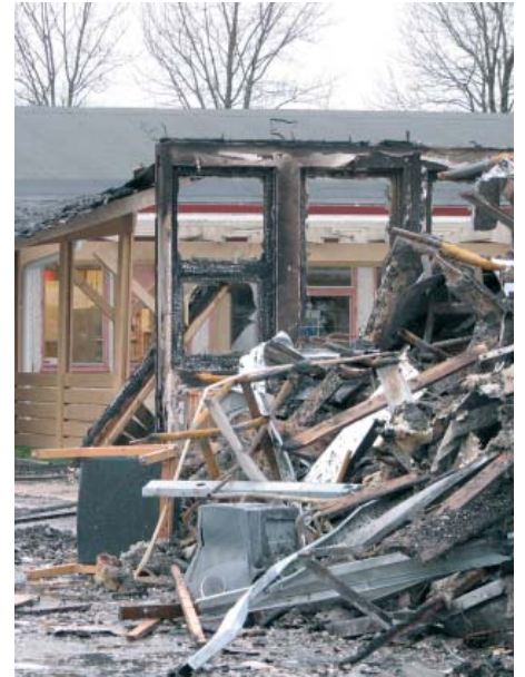
Resterna efter en anlagd brand i Hjällsnässkolan, november 2007.
